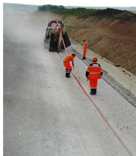
линейно-кабельные сооружения транспортной многоканальной коммуникации» (ЛКС ТМК).
